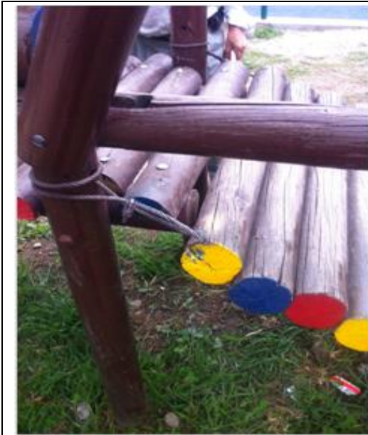
Foto 5. Parque infantil en mal estado, presenta elementos peligrosos para los infantes
