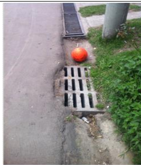
Foto 8. Deficiente acabado en la unión con las rejillas del alcantarillado.
