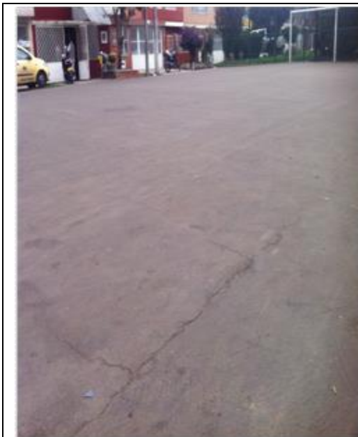
Foto 7. La BASE ASFALTICA B 1350 presenta fisuras tal y como se observa falta de marcación de la cancha.
