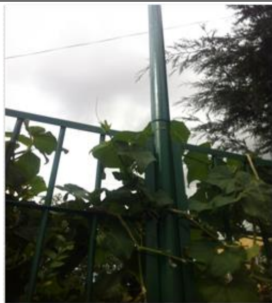
Foto 10. Los tubos continuos presentan diferente diámetro.
